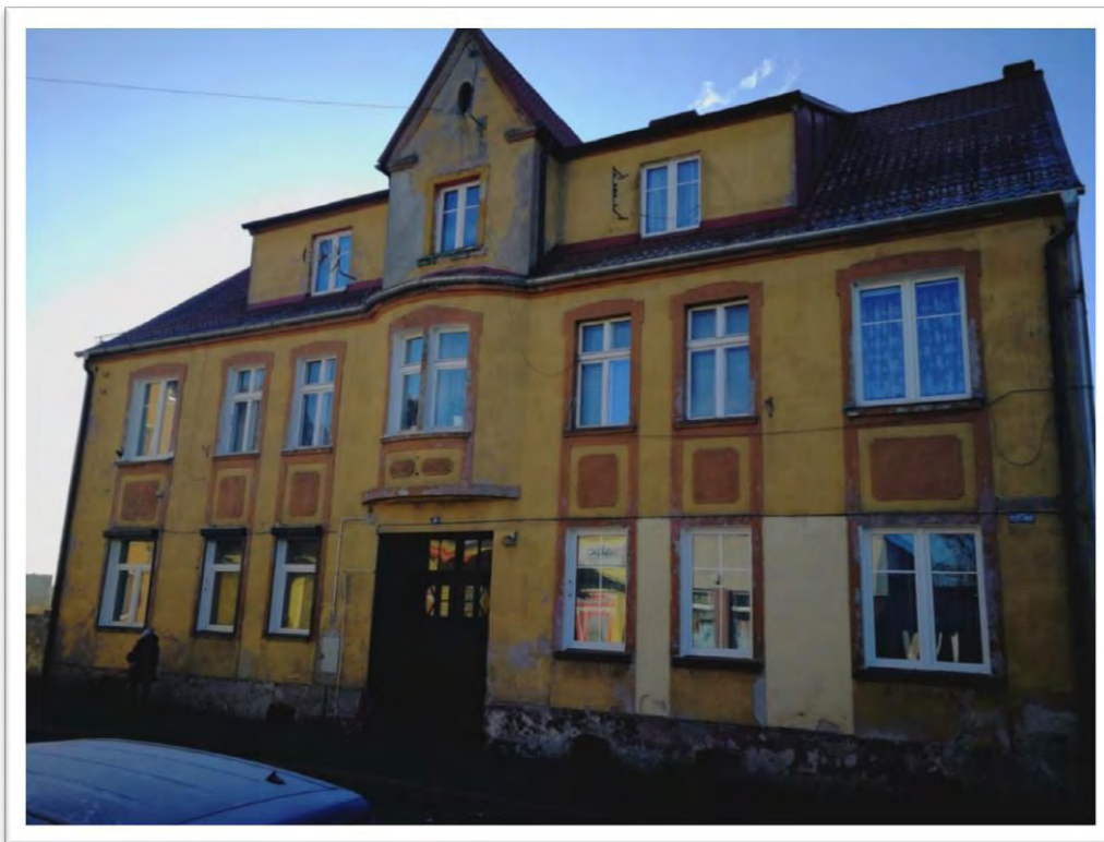
Zdjęcie 4 Budynek w złym stanie technicznym przy ul. Kardynała Wyszyńskiego
