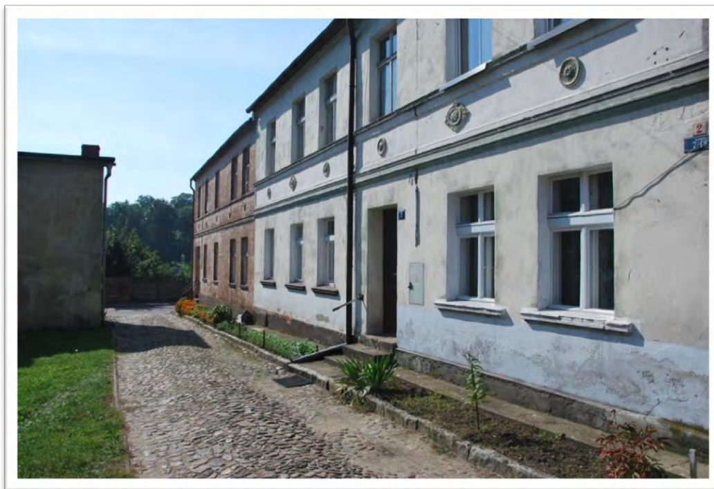
Zdjęcie 5. Budynek w złym stanie technicznym przy ul. Zabytkowej
